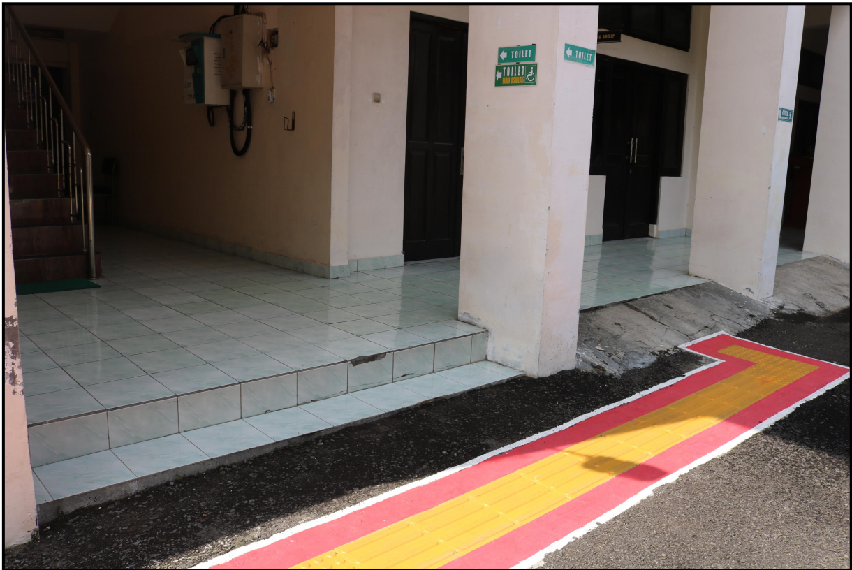
Guiding Block Menuju Ke Toilet Difabel
