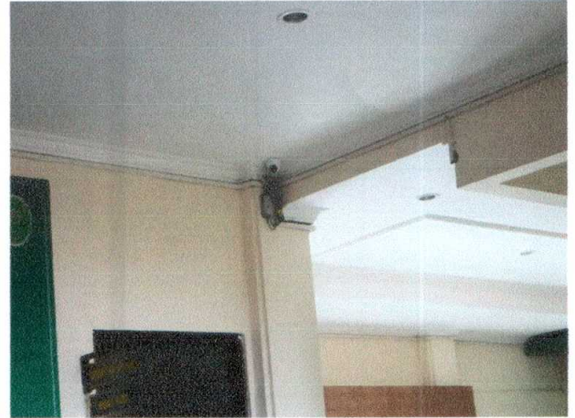
CCTV Dalam Gedung Kantor
