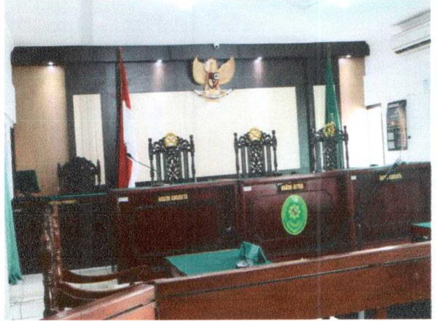
Kamera CCTV R. Sidang
