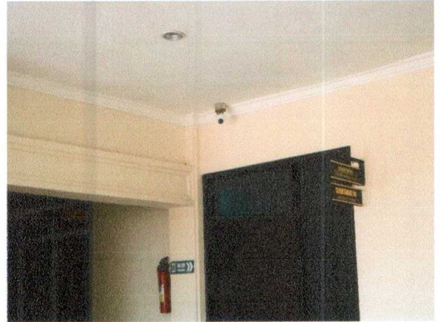
CCTV Dalam Gedung Kantor
