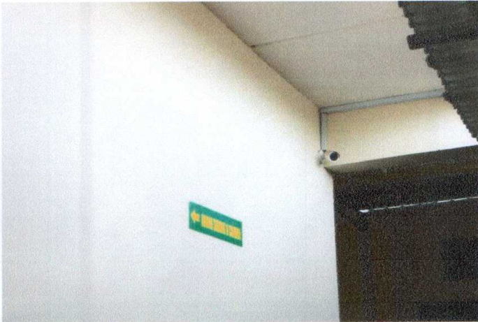
CCTV Luar Gedung Kantor
