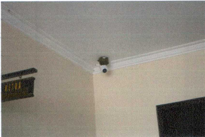
CCTV Dalam Gedung Kantor
