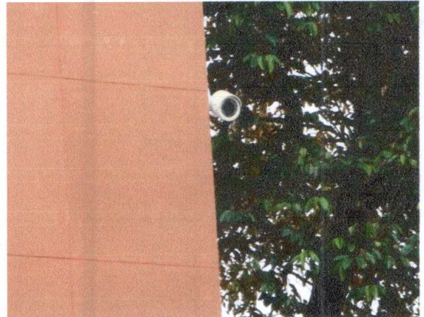
CCTV Luar Gedung Kantor
