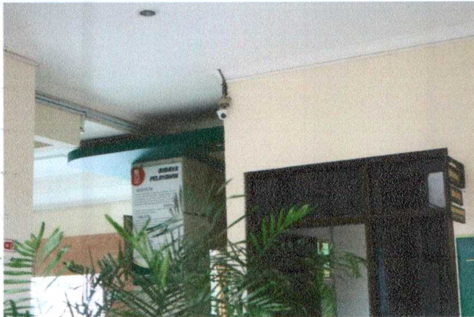
CCTV Dalam Gedung Kantor
