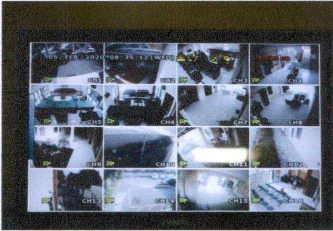
Monitor dan Recorder CCTV
