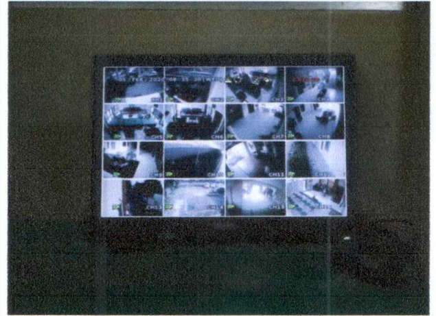
Monitor dan Recorder CCTV
