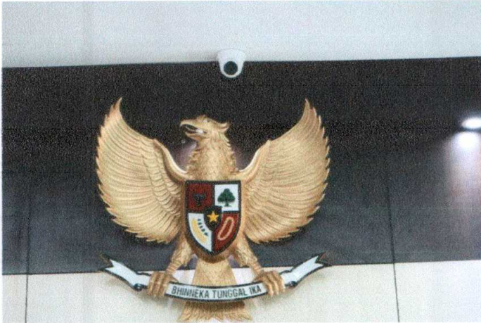
Kamera CCTV R. Sidang
