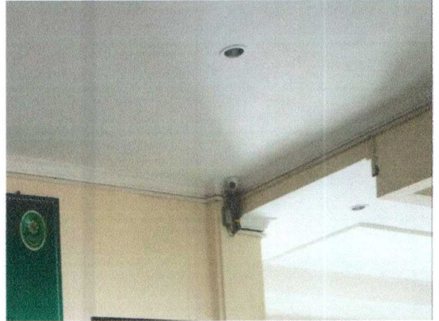
CCTV Luar Gedung Kantor
