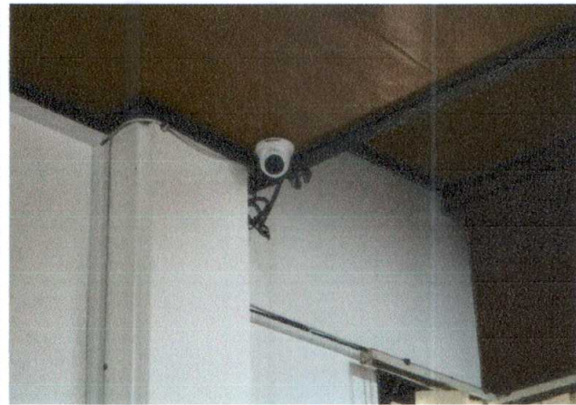
Kamera CCTV R. Sidang
