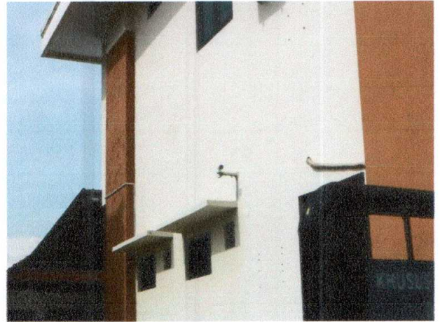
CCTV Luar Gedung Kantor
